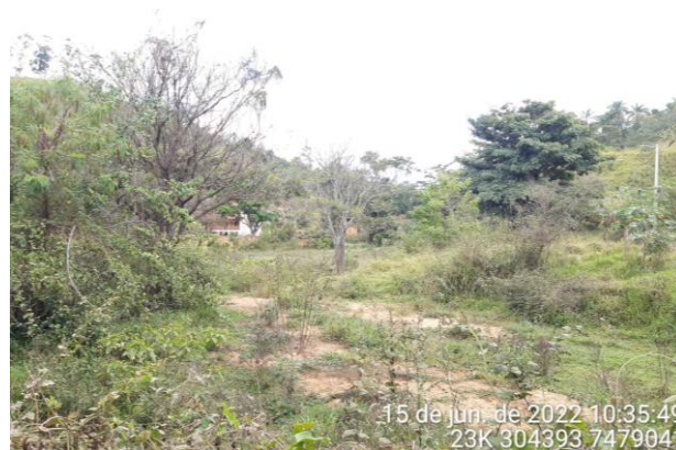
Foto 10 – Drenagem com acúmulo de sedimentos. Ponto 5. (Data: 15/06/2022).
