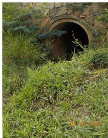
Foto 3.2.1-2. Ausência de escoamento superficial na tubulação à altura do P07.
