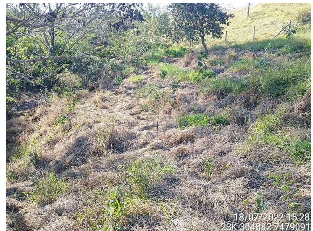
Foto 6 – Erosões superficiais foram minimizadas pela cobertura vegetal. (Data: 18/07/2022).
